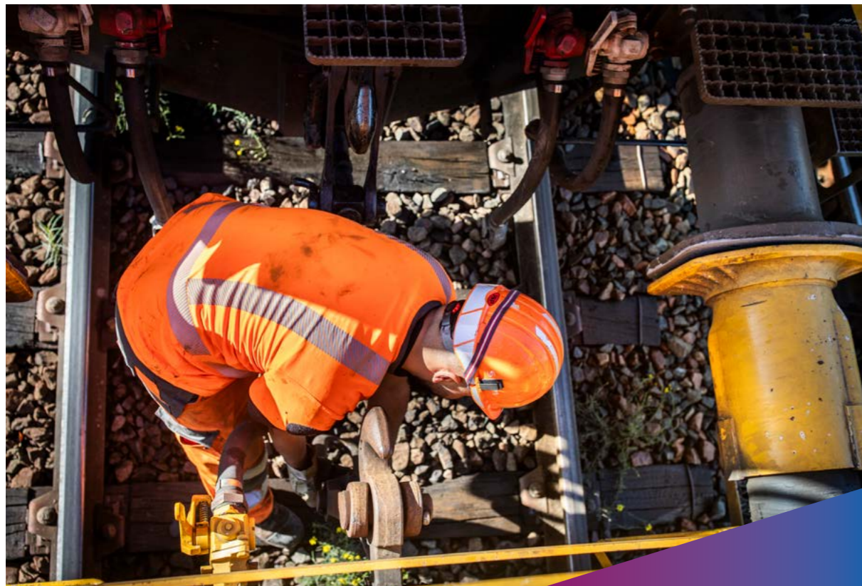
Formation des trains (assemblage ou séparation) pour les opérations d'entretien et préparation au départ sur le chantier de nuit.
