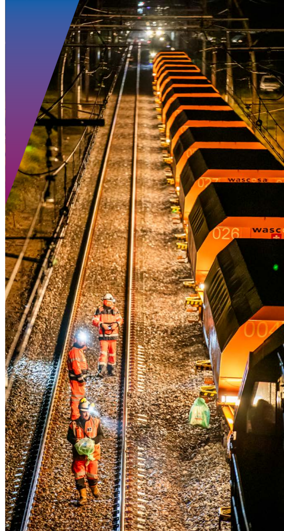
3 HEURES DU MATIN : LE TRAIN DE BALLAST DÉGAGE LA ZONE DE TRAVAUX À LA FIN DE L'INTERVENTION DE LA « SUITE RAPIDE ».
