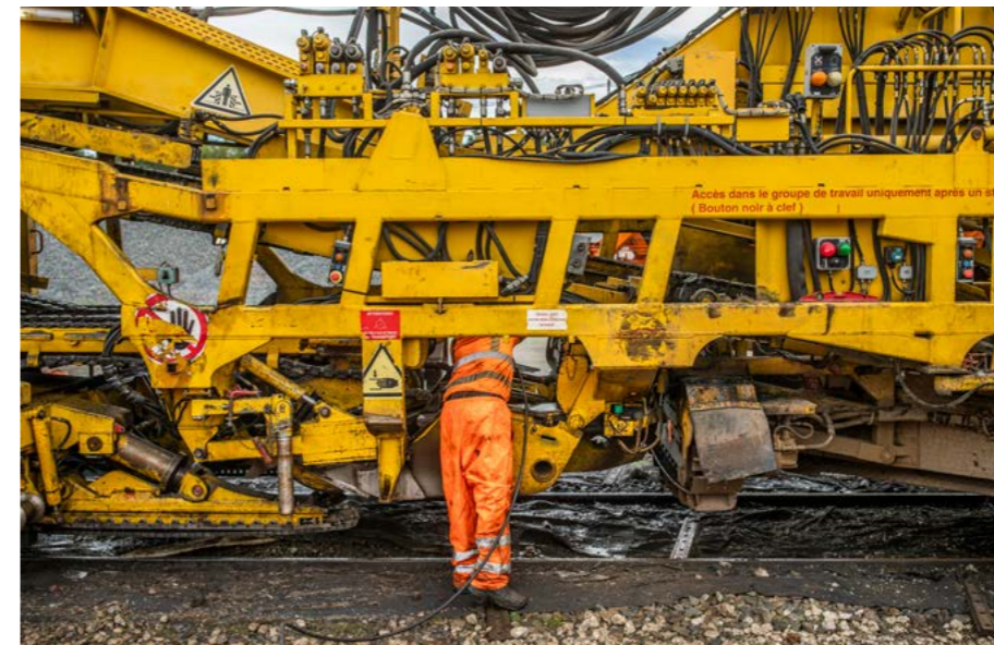
Entretien et nettoyage du train de substitution.
